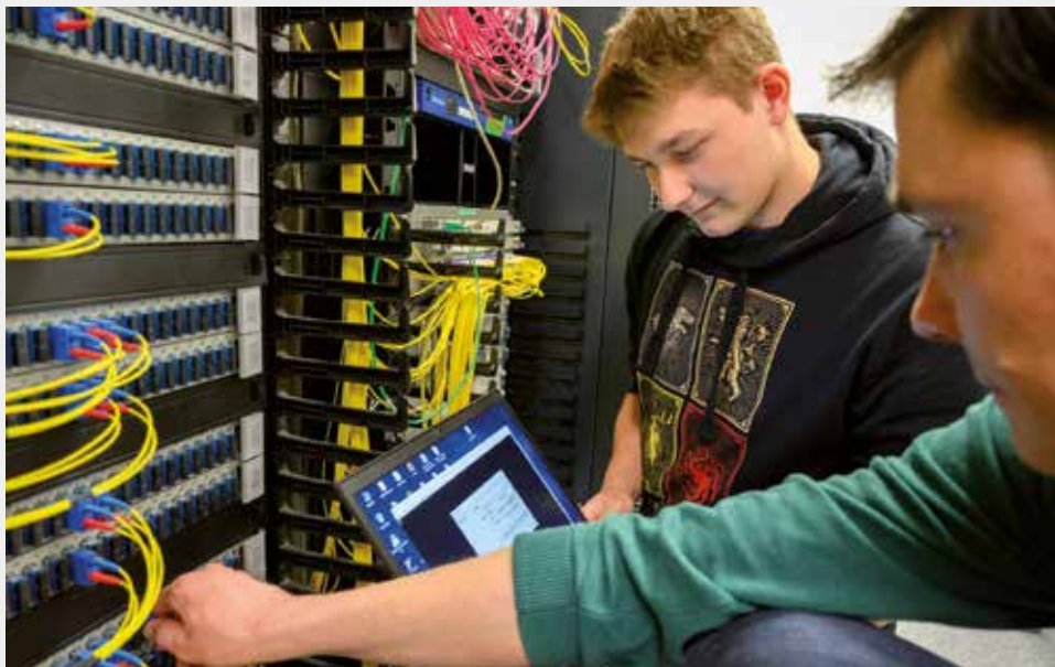
Kabelsalat? Kein Problem für das Team der Klinik-IT
